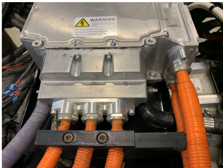
Onduleur avec étiquette haute tension, câbles HT orange sécurisés et unité de refroidissement
