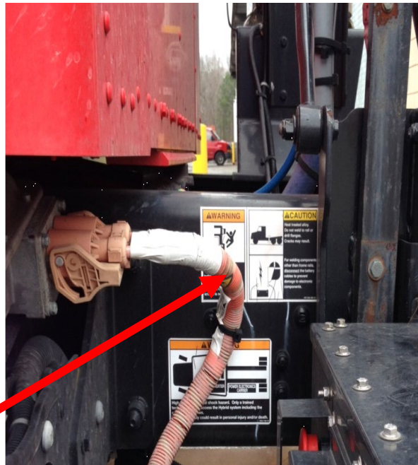
Figure 7 : Exemple d'un câble orange de véhicule à propulsion électrique
